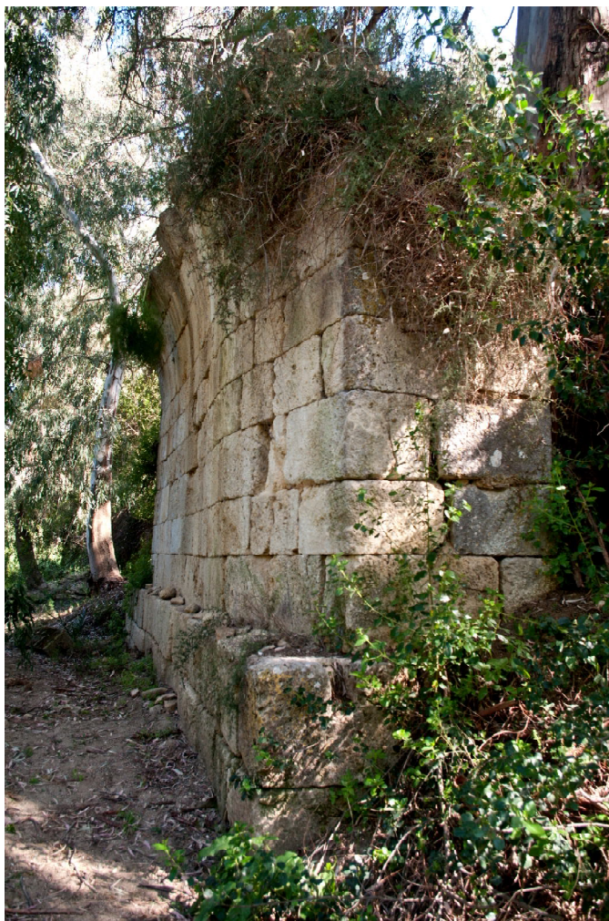
Figura 4. Il muro d'appoggio del ponte visto dal lato monte. In basso la sporgenza della fondazione.
