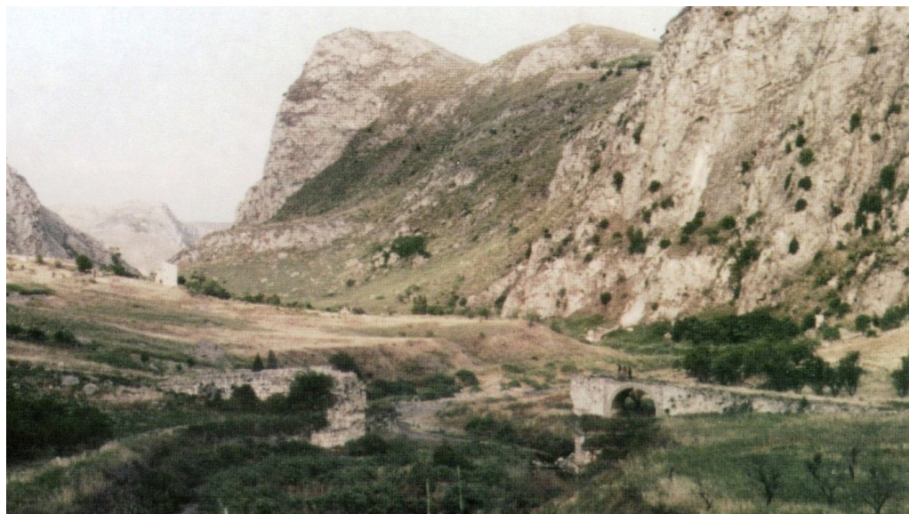
Figura 26. Il ponte oggi, ormai crollato nella parte centrale. Sulla destra si vede l'arcata realizzata nel 1935 e le due lunghe rampe d'accesso.
