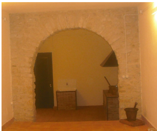
Un arco a tutto sesto ancora esistente, rimasto nel corpo che si affaccia su via Xiboli.
