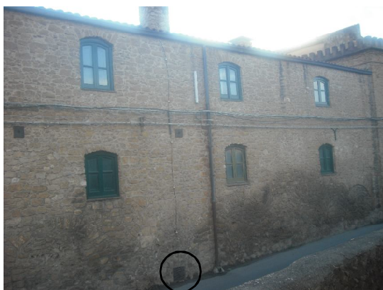
Alcuni archi chiusi su via Xiboli. In alto si distinguono alcune finestre chiuse. A sinistra in basso una grata di aereazione.
