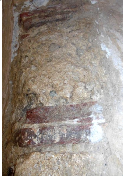
Figura 9 - Brano di muratura in opus mixtum che caratterizza un arcone della campata centrale.
