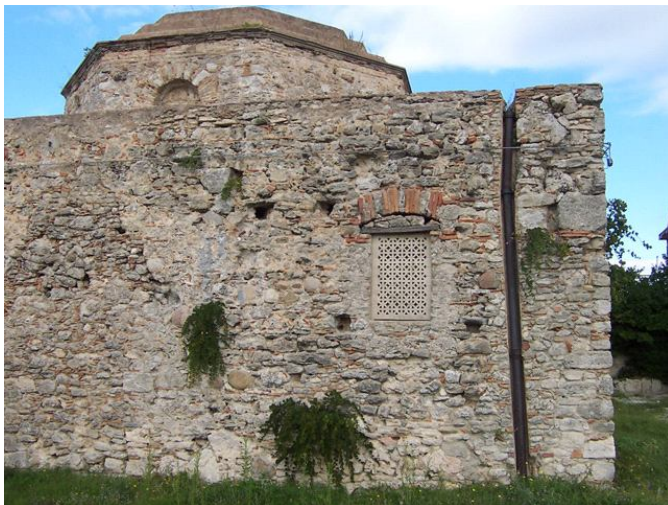
Figura 7. Rometta, chiesa di Santa Maria dei Cerei, fronte sud. Uno dei tre canali di alloggiamento dei pluviali in catusi ripristinati da Valenti, oggi sostituiti da elementi in ghisa.
