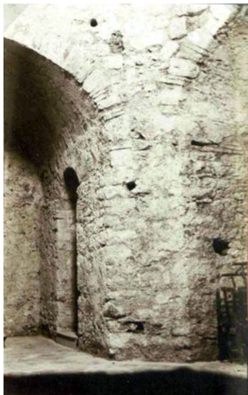
Figura 13. Rometta, chiesa di Santa Maria dei Cerei, stampa fotografica. Il momentaneo rinvenimento degli arconi interni ad opus mixtum a seguito della rimozione dell'intonaco.
